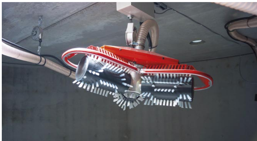
Die Montage des programmgesteuerten Holzpellet-Entnahmesystems „Maulwurf“, hier vor der Befüllung unter der Decke des Speichers arretiert, ist inklusive flexibler Saugleitung bis zur Adapterplatte eine Leistung des Speicherherstellers.
