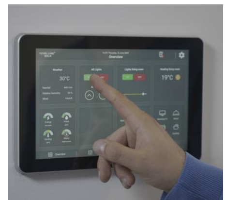
Die Digitalisierung und Vernetzung beginnt in den Wohnungen. Die Smart Home-Steuerung bietet Komfort, Sicherheit und Energieeinsparung.
